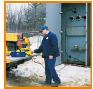
Pomiar na 3-fazowym transformatorze 2.000 kVA w terenie
